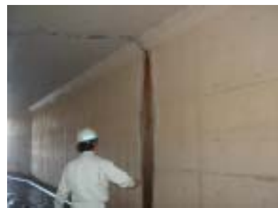
写真-11 大堀樋門のクラック
