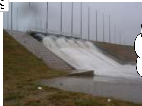
写真-3 迫排水機場の排水状況(台風23号)
