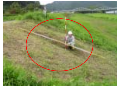
写真-2 堤防の陥没例
